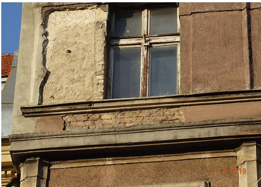
Fragment elewacji ostatniej kondygnacji – duże połacie tynku pomimo podjętych prób renowacji odpadły, również stolarka okienna - stan techniczny
