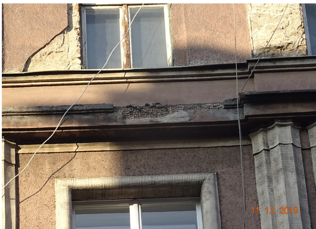
Fragment środkowy elewacji powyżej 2 piętra z widocznymi uszkodzeniami gzymsu, obróbek blacharskich i tynku. Widoczne rowkowanie półkolumn.
