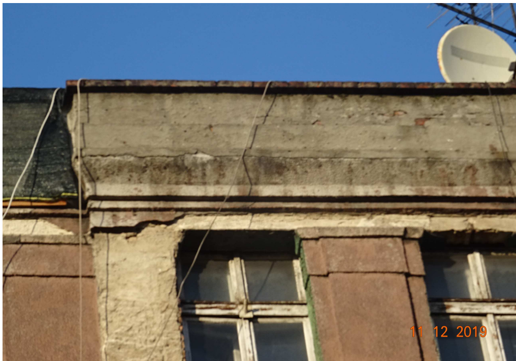
Fragment prawej strony elewacji powyżej poddasza z widocznymi uszkodzeniami gzymsu, obróbek blacharskich i tynku. Widoczne zacieki gzymsu i brak tynku na ścianie i pod gzymsem., stan techniczny stolarki okiennej zły.
