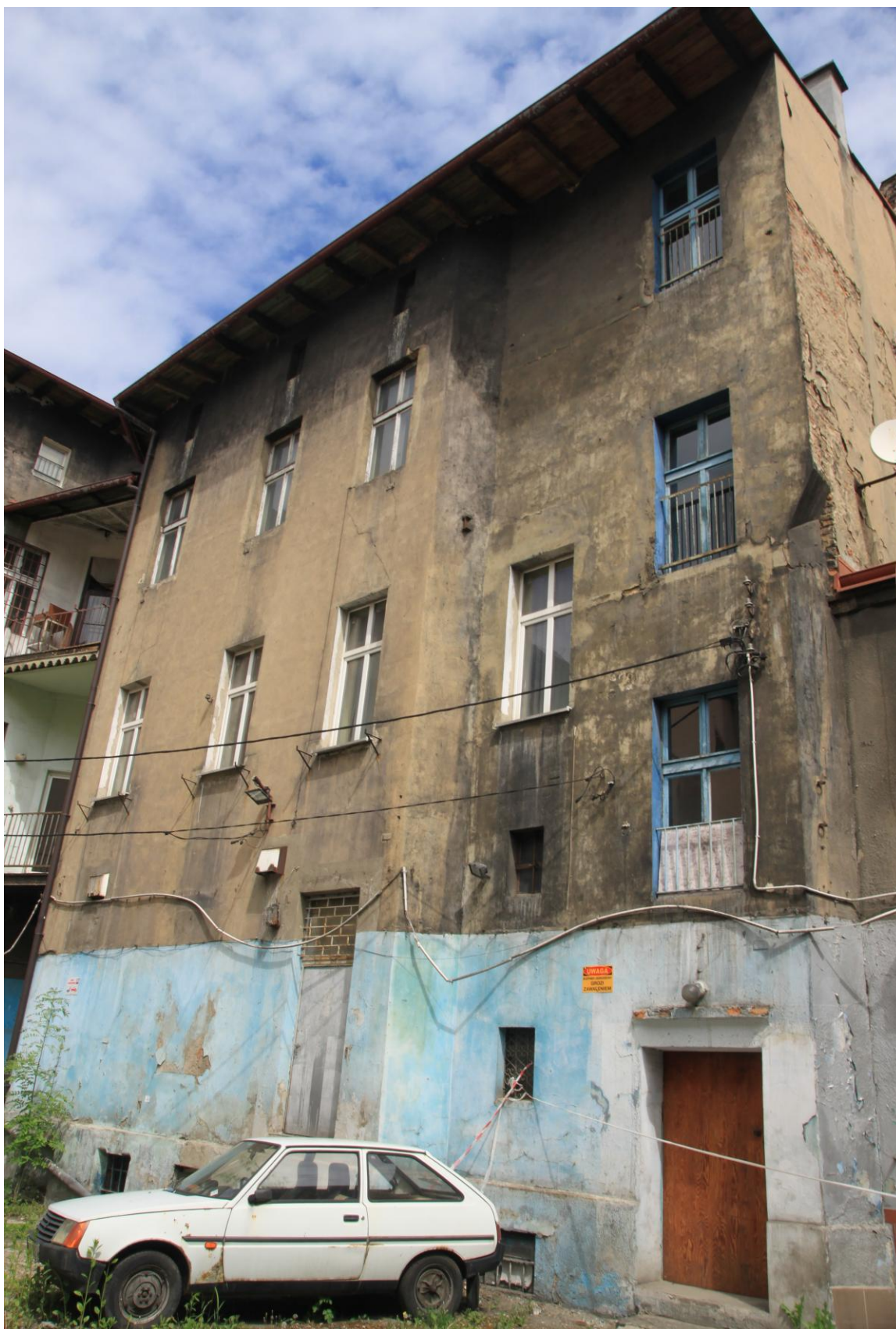
Rys. nr 22. Zacieki, odparzenia tynku, zabrudzenia korozyjne, znacznie wyeksploatowana stolarka okienna poddasza, ogniska korozji belek stalowych balkonów, brak odpowiedniej wysokości balustrady, korozja i wyeksploatowanie rury spustowej, brak odpowiedniego jej zakończenia i wyprowadzenia na tereny zielone lub do kanalizacji, brak zadaszenia nad wejściem [1.3.].
