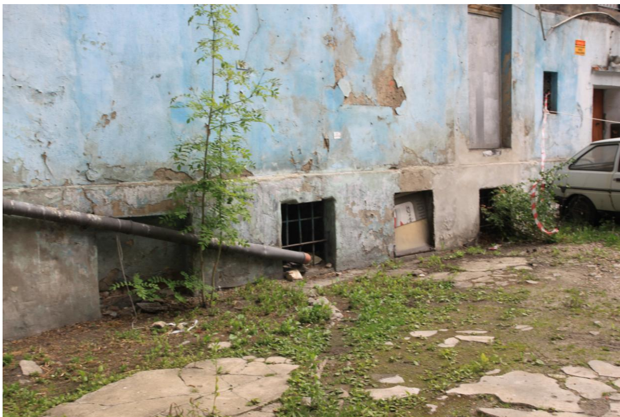
Rys. nr 25. Korozja i wyeksploatowanie rury spustowej, brak odpowiedniego jej zakończenia i wyprowadzenia na tereny zielone lub do kanalizacji, brak oszklenia w oknach piwnicznych [1.3].
