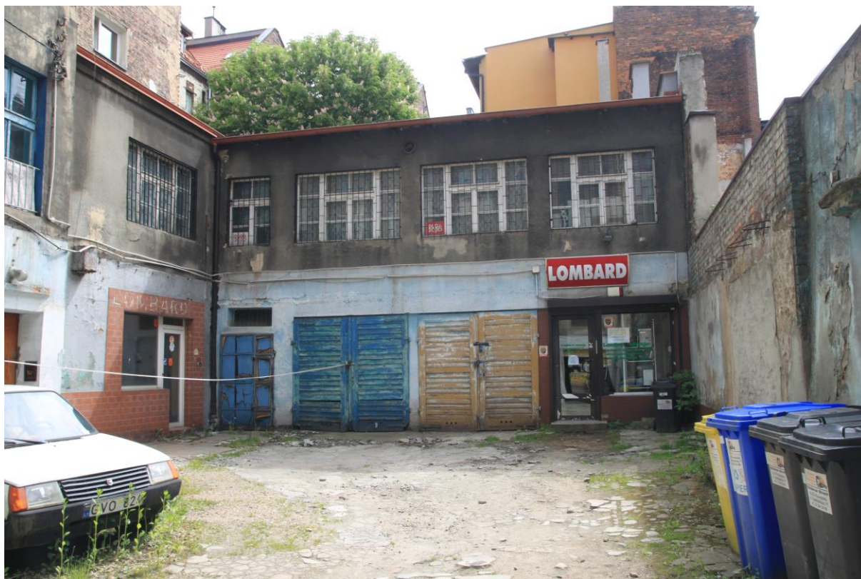
Rys. nr 27. Odparzenia tynków, łuszczenie się powłoki malarskiej z drewnianych drzwi i bram wjazdowych, znacznie wyeksploatowane drewno, zarysowania poziome tynków, brak estetyki elewacji, miejscowe odparzenia tynków, brak estetyki terenu przyległego do budynku - podwórza [1.3].
