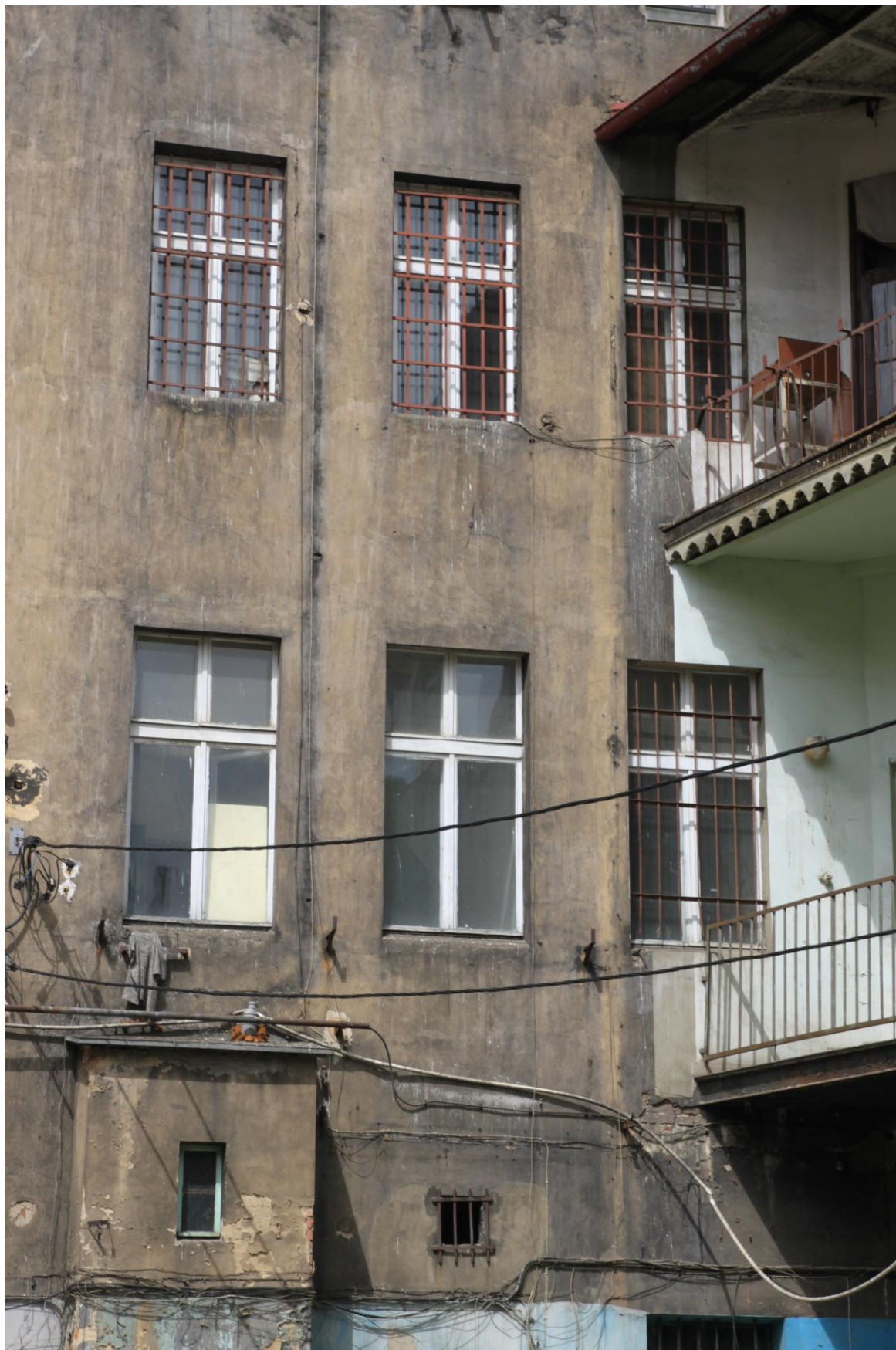
Rys. nr 5. Widok elewacji południowo-zachodniej budynku przy ul. Dworcowej 21 w Bytomiu [1.3.].
