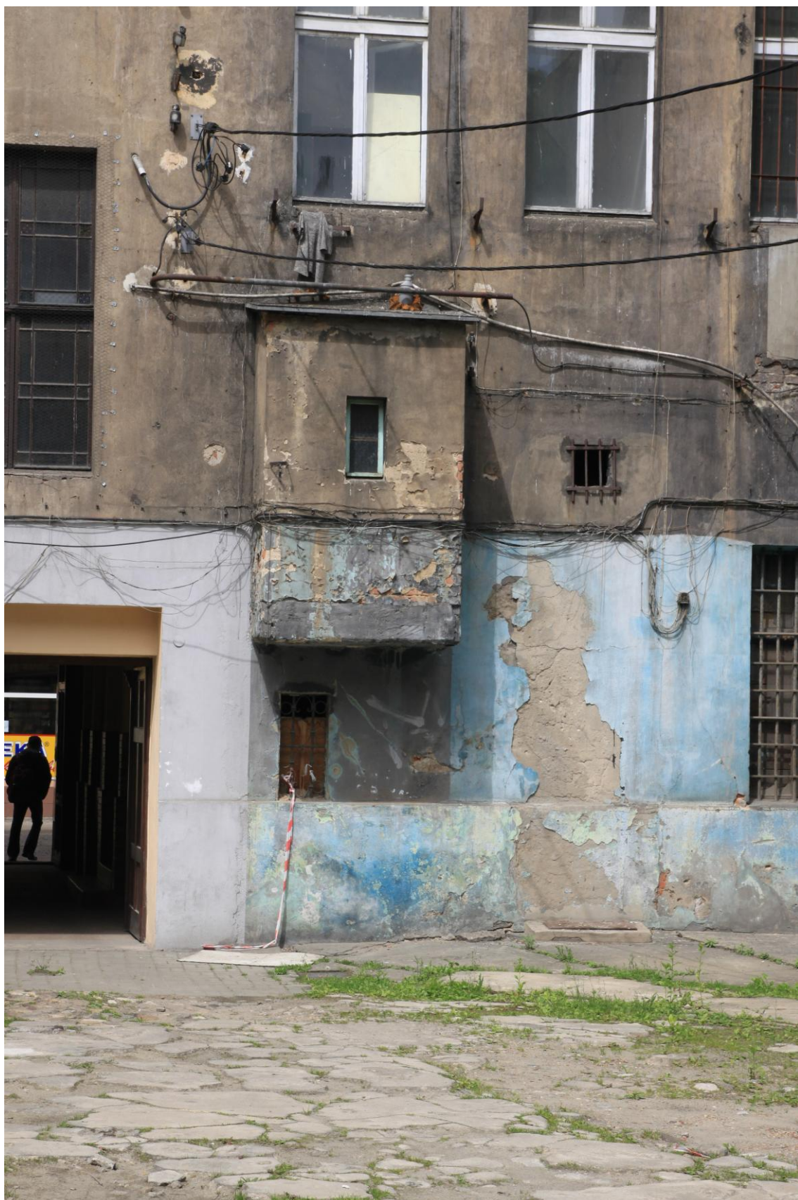
Rys. nr 18. Spękania i znaczne ubytki tynku na elewacji od strony podwórza, wyeksploatowana stolarka okienna, korozja elementów metalowych, brak estetyki – okablowanie na całej powierzchni elewacji [1.3].
