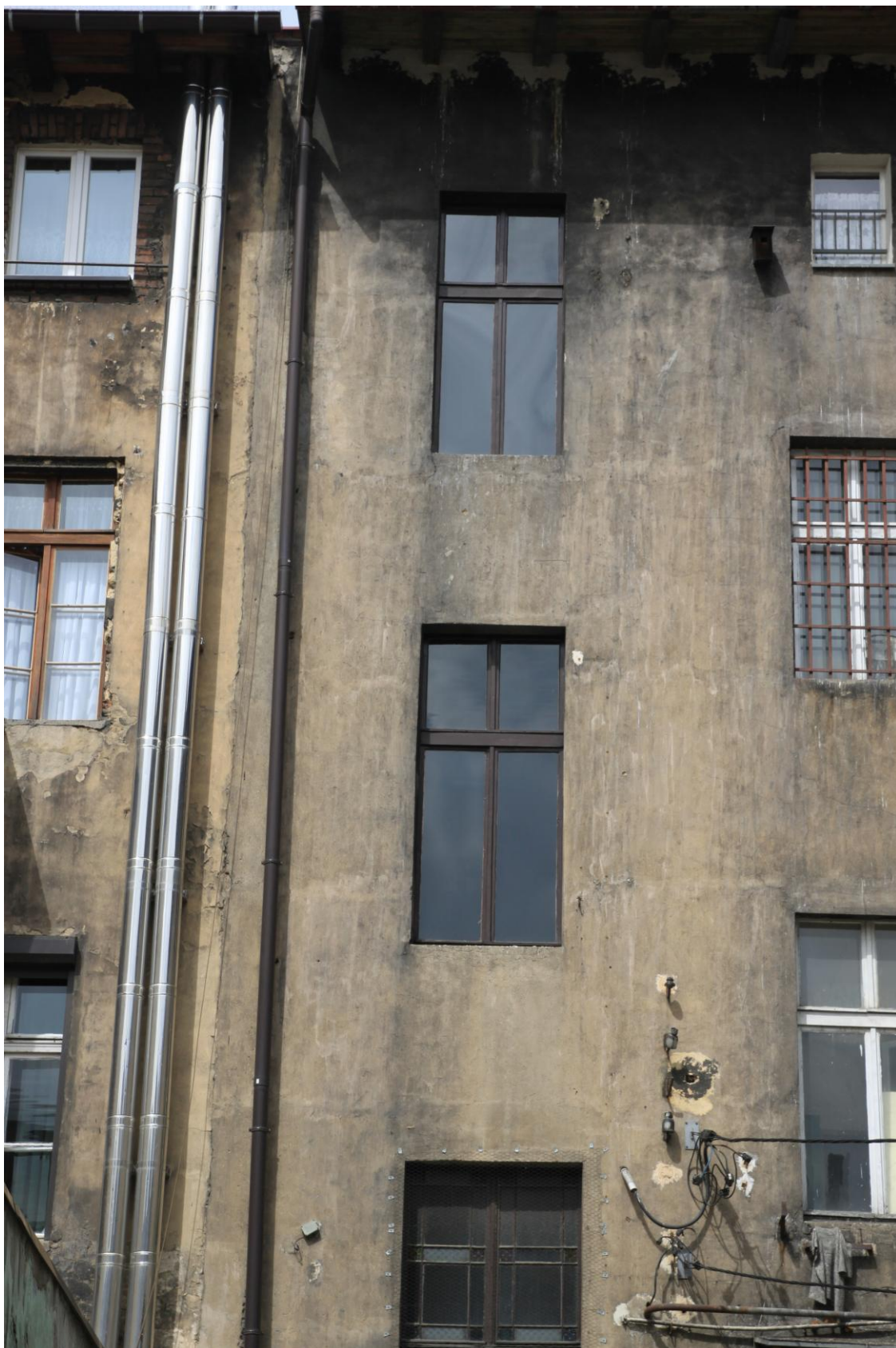
Rys. nr 19. Przebarwienia, zabrudzenia korozyjne tynku, znacznie wyeksploatowana stolarka okienna [1.3].
