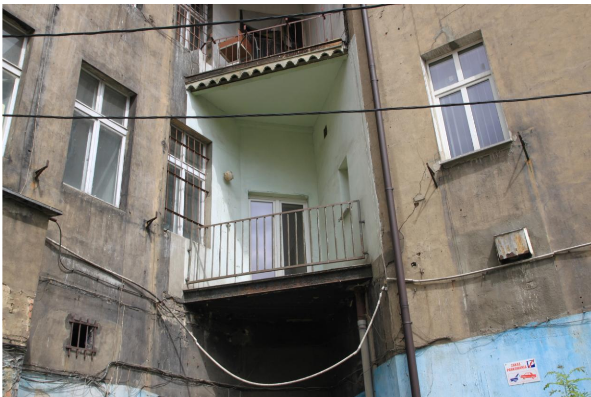
Rys. nr 23. Zacieki, odparzenia tynku, zabrudzenia korozyjne, znacznie wyeksploatowana stolarka okienna poddasza, ogniska korozji belek stalowych balkonów, brak odpowiedniej wysokości balustrady, korozja i wyeksploatowanie rury spustowej [1.3].
