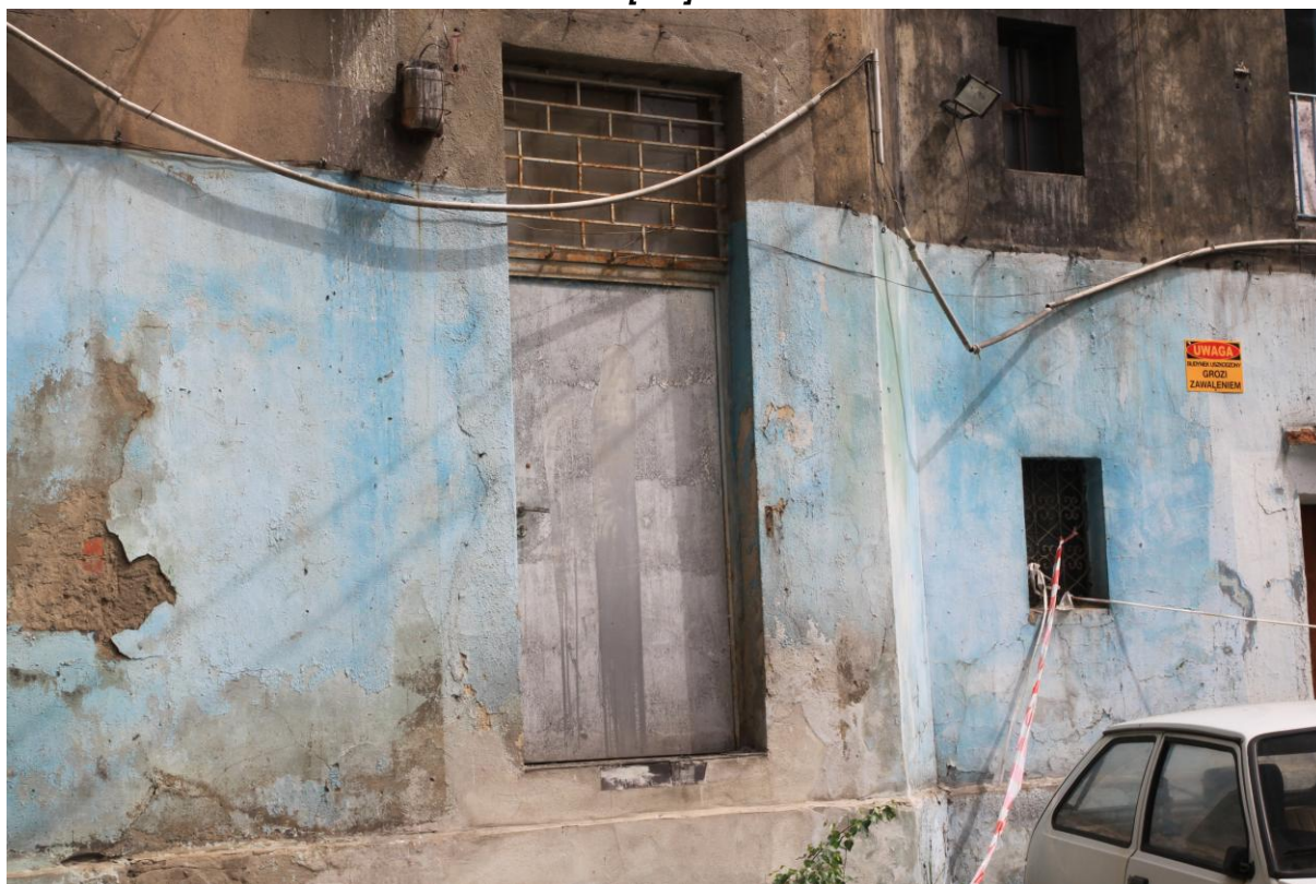
Rys. nr 28. Odparzenia i przebarwienia tynków, brak zadaszenia and wejściem, wyeksploatowane i zniszczone drzwi wejściowe, brak schodów do wejścia – brak możliwości wejścia z poziomu zero do pomieszczenia, korozja elementów metalowych [1.3].
