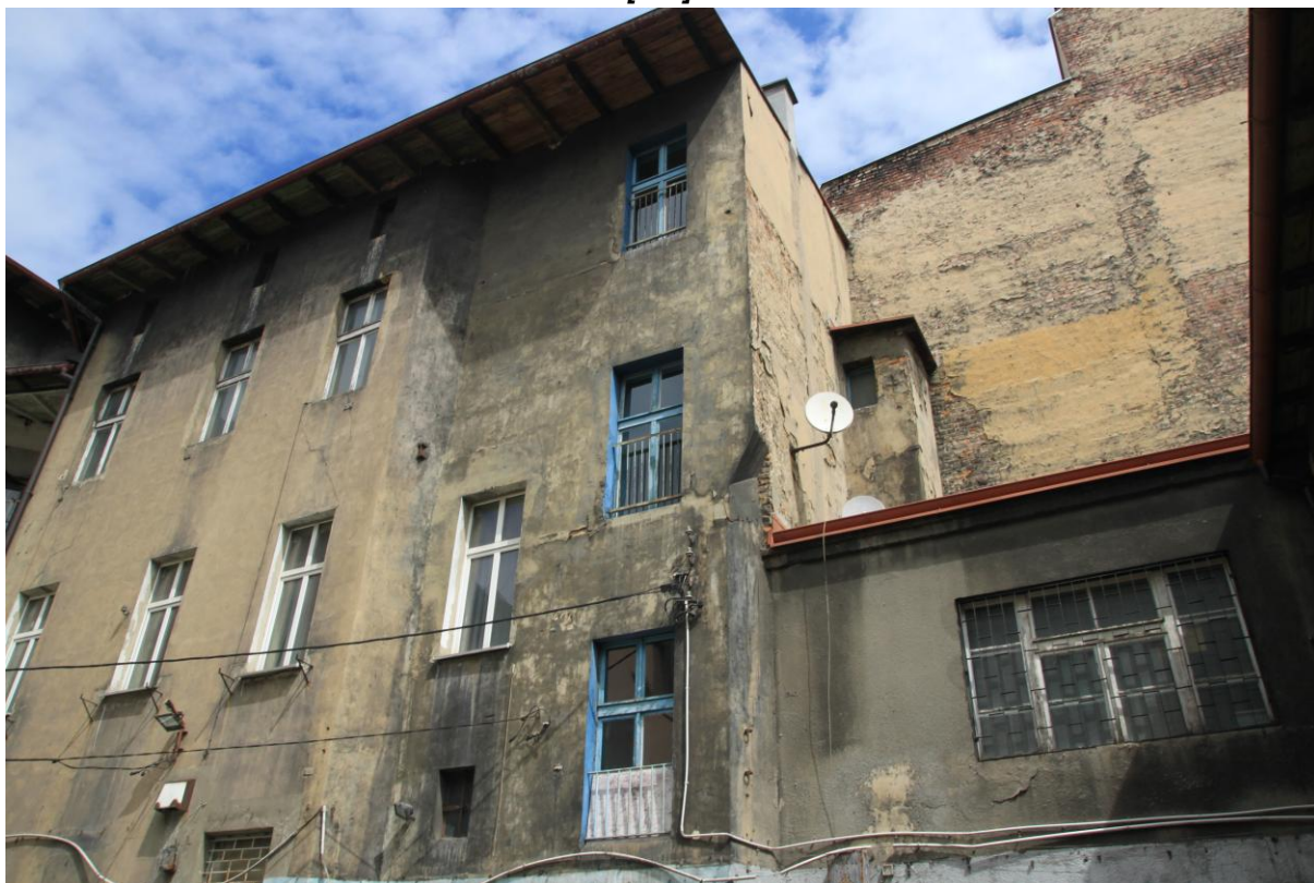
Rys. nr 21. Zacieki, odparzenia tynku, zabrudzenia korozyjne, znacznie wyeksploatowana stolarka okienna poddasza, brak parapetów zewnętrznych [1.3.]
