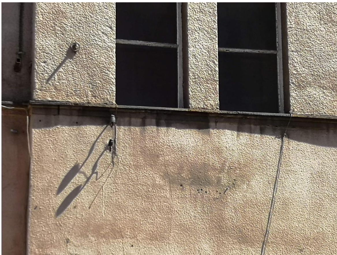
Rys. nr 14. Zabrudzenia korozyjne, doksztalcenia i korozja obróbki blacharskiej. Spękania, odparzenia i ubytki tynku. Uszkodzenia detali architektonicznych [1.3].
