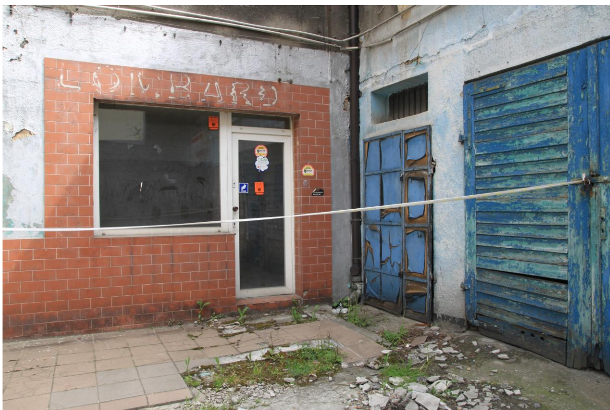
Rys. nr 26. Odparzenia tynków, łuszczenie się powłoki malarskiej z drewnianych drzwi i bram wjazdowych, znaczne wyeksploatowane drewno, zarysowania poziome tynków [1.3].
