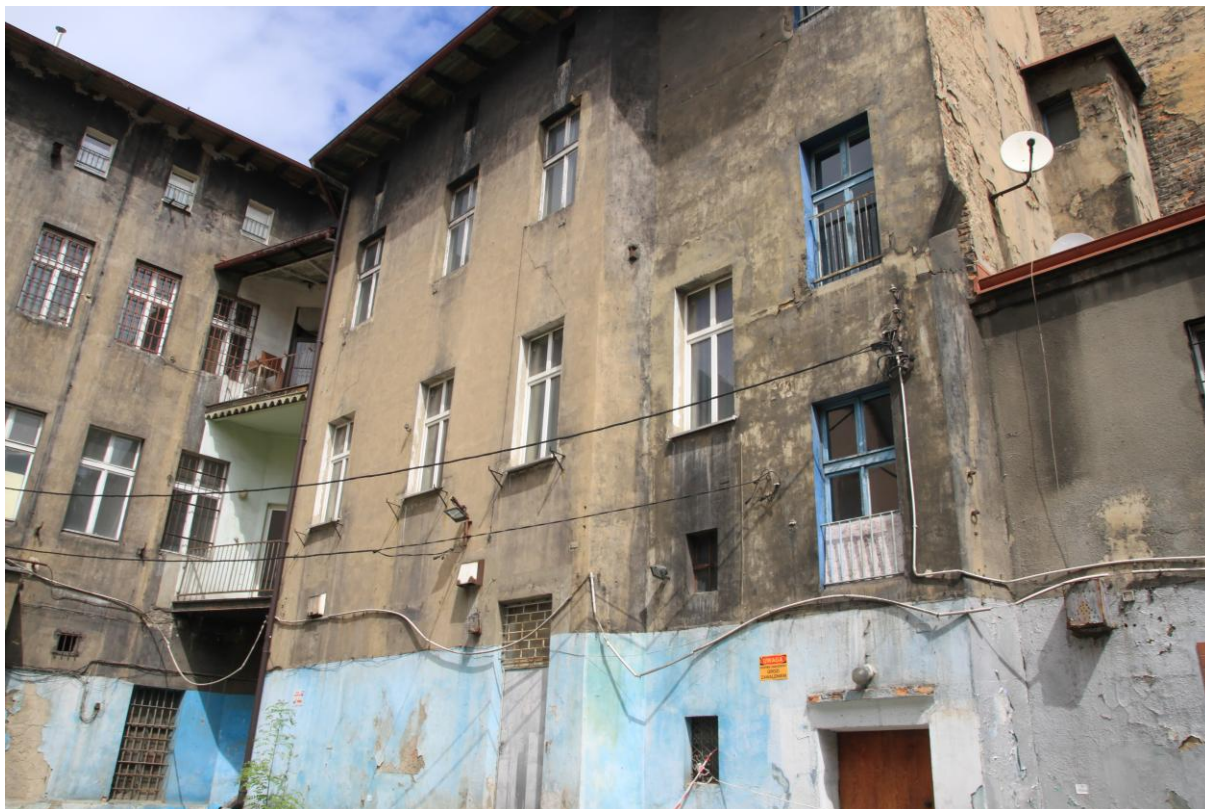
Rys. nr 20. Zacieki, odparzenia tynku, zabrudzenia korozyjne, znacznie wyeksploatowana stolarka okienna poddasza, ogniska korozji belek stalowych balkonów, brak odpowiedniej wysokości balustrady, korozja i wyeksploatowanie rury spustowej, brak odpowiedniego jej zakończenia i wyprowadzenia na tereny zielone lub do kanalizacji, brak zadaszenia nad wejściem [1.3].
