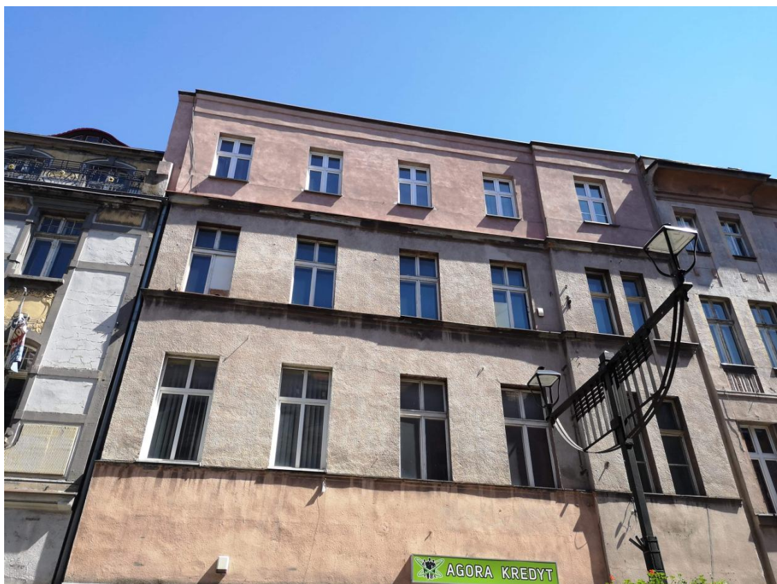
Rys. nr 13. Zabrudzenia, przebarwienia, zacieki korozyjne od obróbek blacharskich na całej powierzchni elewacji frontowej. [1.3.].
