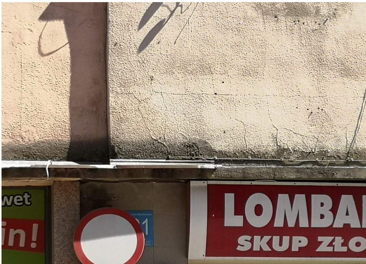
Rys. nr 16. Zabrudzenia na powierzchni ścian. Spękania, odparzenia w obszarze gzymsu, korozja obróbek blacharskich, jej odkształcenia i miejscowy brak ciągłości obróbek [1.3.].
