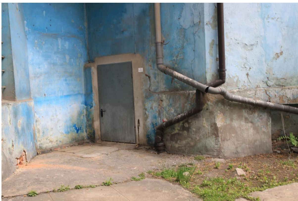
Rys. nr 11. Widok drzwi – w obrębie pod balkonami budynku przy ul. Dworcowej 21 w Bytomiu – elewacja od strony podwórza [1.4.]
