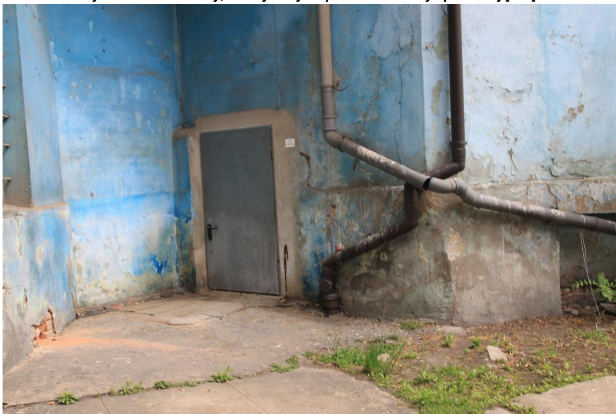
Rys. nr 24. Korozja i wyeksploatowanie rury spustowej, brak odpowiedniego jej zakończenia i wyprowadzenia na tereny zielone lub do kanalizacji, brak oszklenia w oknach piwnicznych[1.3]. [1.3].
