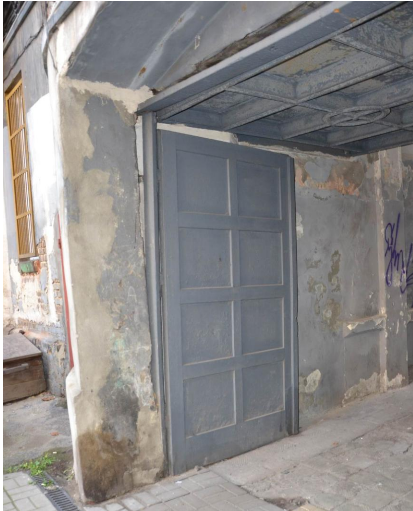
Rys. nr 25. Zawilgocenia ścian przyziemia przejazdu [1.3].
