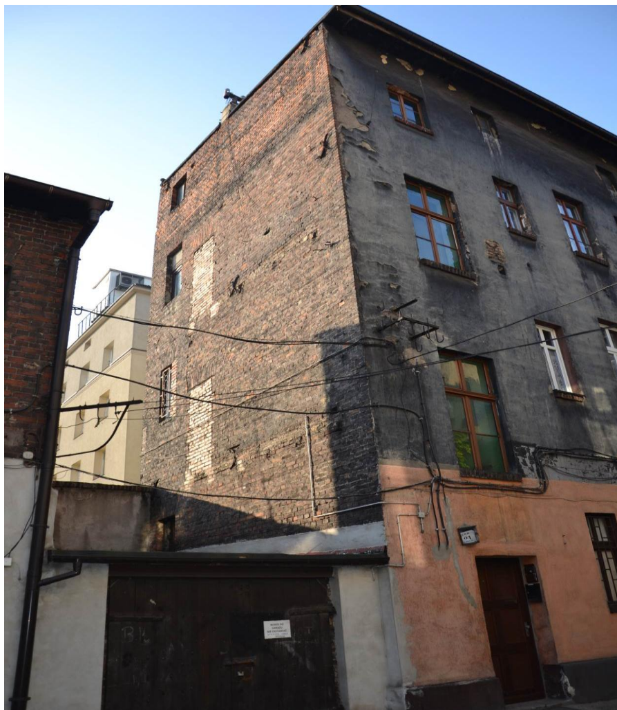
Rys. nr 18. Lokalnie rozległe odparzenia tynku, przebarwienia tynku, brak estetyki elewacji, miejscowe drobne zarysowania tynków [1.3].
