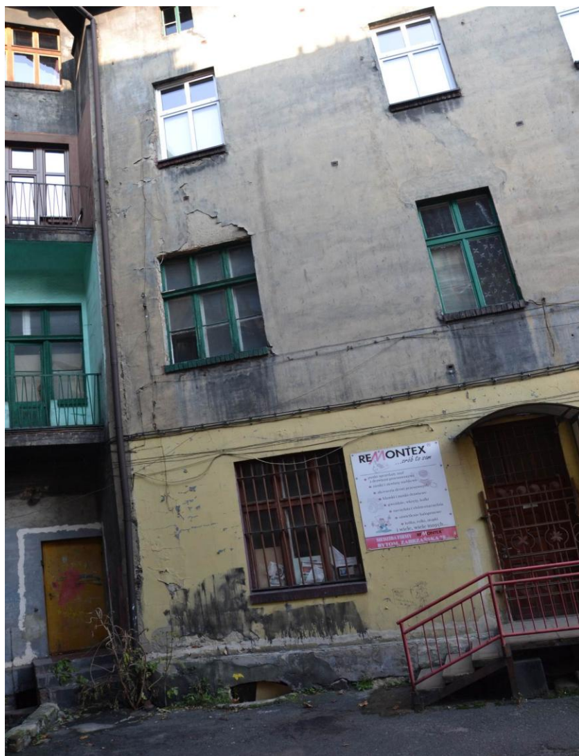
Rys. nr 31. Zabrudzenia, zacieki na całej powierzchni tynku elewacji, odparzenia tynku, zniszczona i dość znacznie wyeksploatowana stolarka okienna poddasza, brak estetyki w okablowaniu [1.3.].
