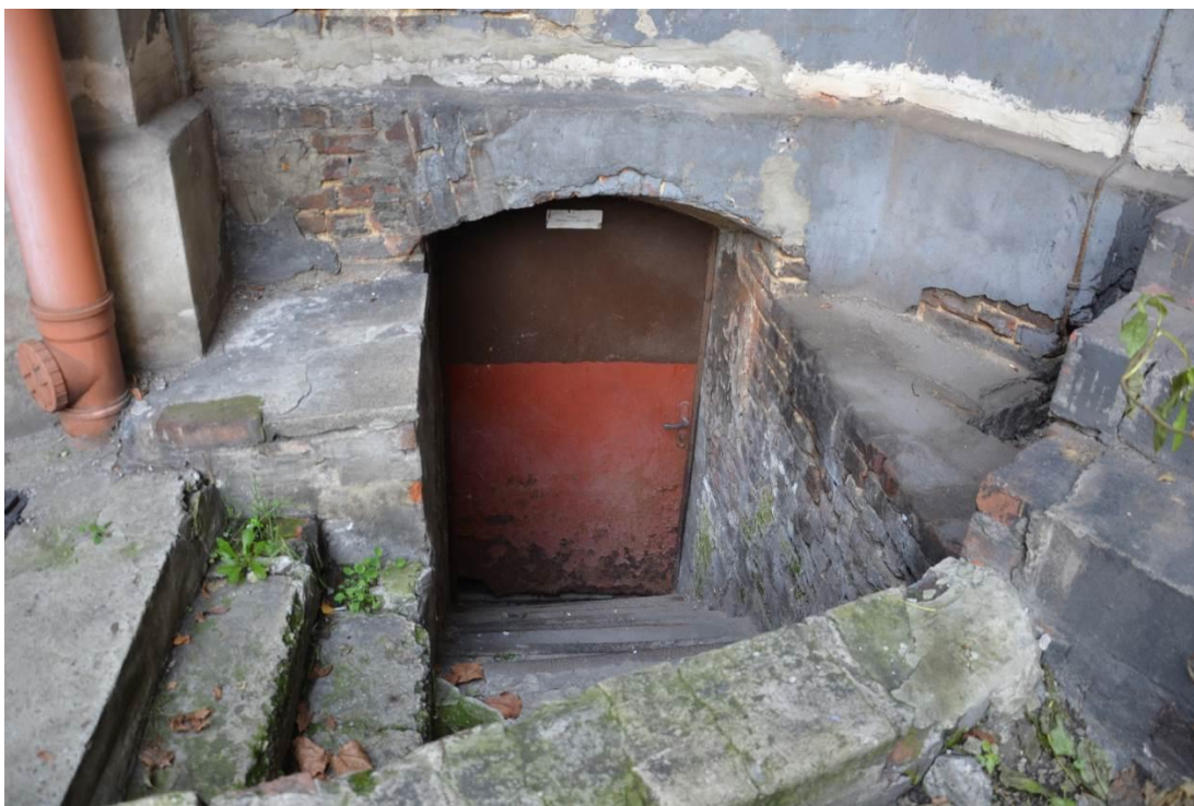
Rys. nr 29. Zawilgocenia i porosty na murku oporowym – zejście do piwnicy/pom. technicznego, zniszczone drzwi wejściowe, odparzenia tynku [1.3].
