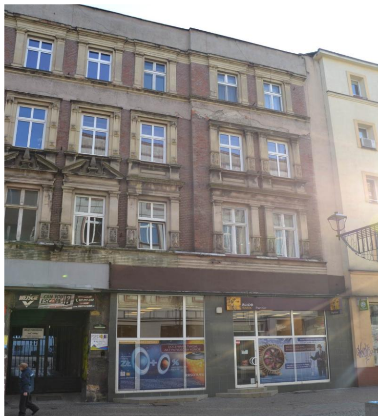
Rys. nr 15. Zabrudzenia na powierzchni ścian. Spękania, odparzenia i ubytki tynku. Uszkodzenia detali architektonicznych [1.3.].
