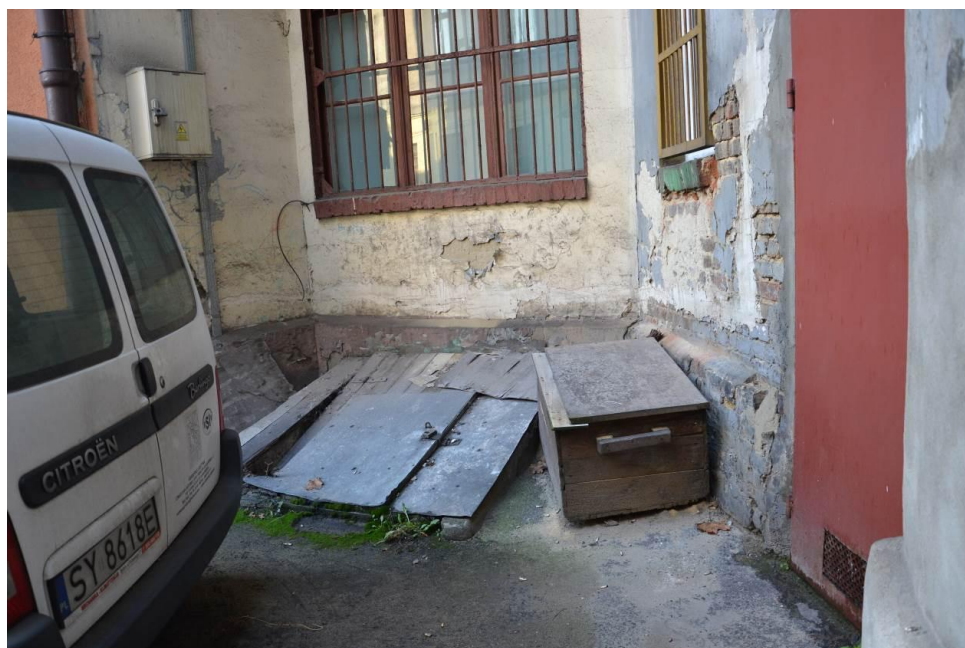
Rys. nr 22. Brak odpowiedniego zabezpieczenia wylazu piwnicznego [1.3].
