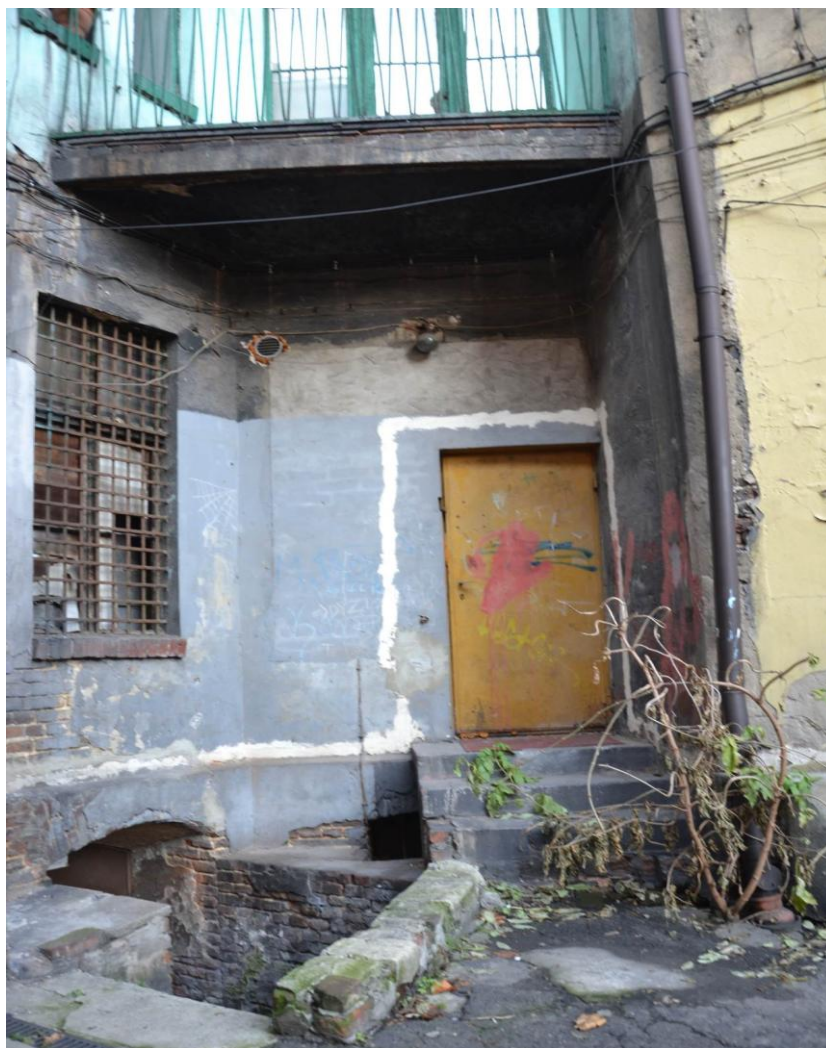
Rys. nr 27. Zawilgocenia ścian przyziemia przejazdu, zmurszałe cegły w murku oporowym – zejście do piwnicy/pom. Technicznego, zniszczone drzwi wejściowe, odparzenia tynku, zniszczona ślusarka okienna i korozja okratowań [1.3].
