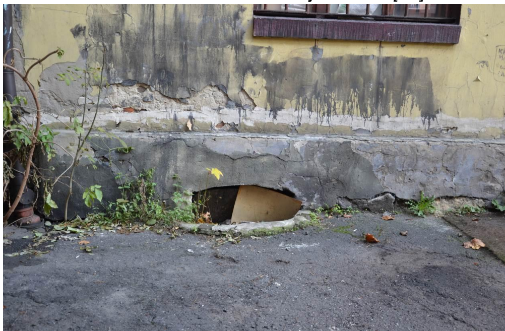
Rys. nr 28. Odparzenia i rozległe zabrudzenia tynku, miejscowe zawilgocenia ścian przyziemia, brak okienka piwnicznego [1.3].
