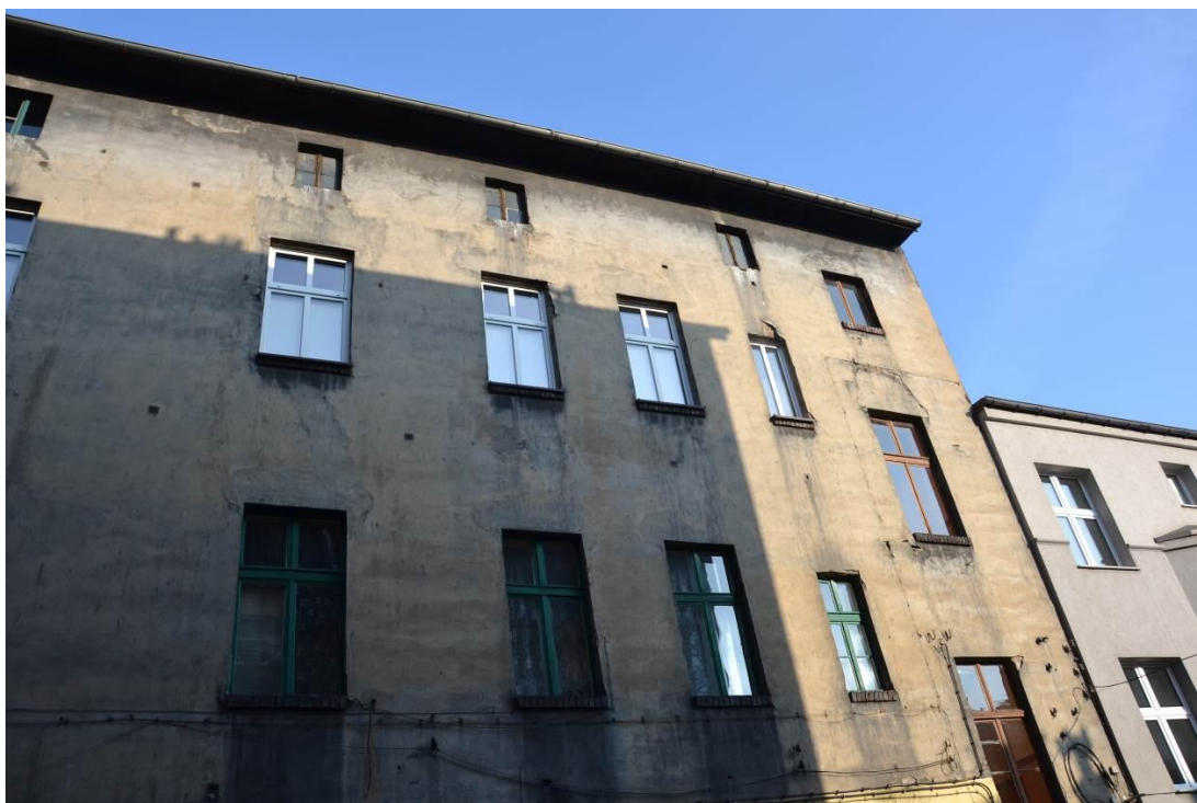
Rys. nr 30. Zabrudzenia, zacieki na całej powierzchni tynku elewacji, zniszczona i dość znacznie wyeksploatowana stolarka okienna poddasza, brak estetyki w okablowaniu [1.3].
