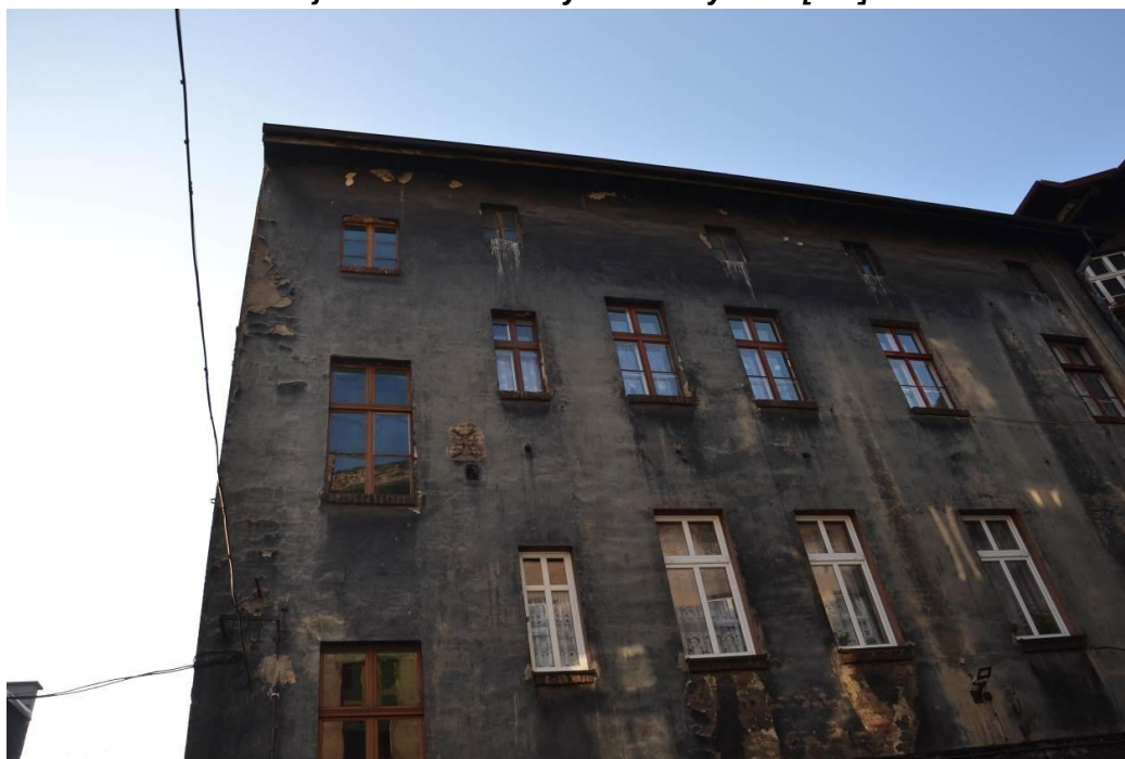
Rys. nr 19. Zacieki, odparzenia tynku, zabrudzenia korozyjne, znacznie wyeksplotowana stolarka okienna poddasza [1.3].
