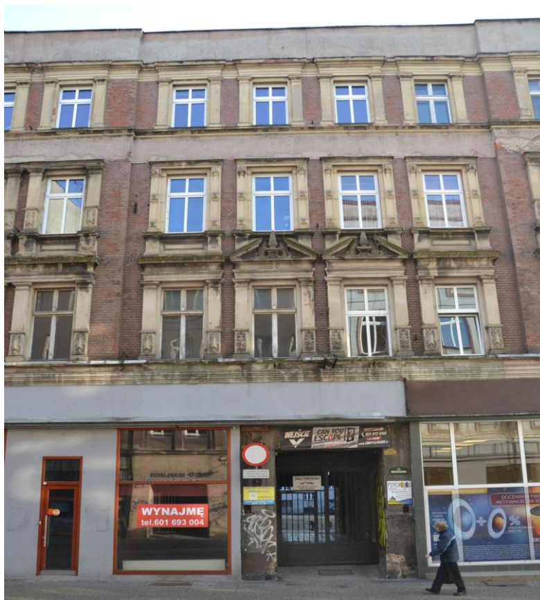
Rys. nr 14. Zabrudzenia na powierzchni ścian. Spękania, odparzenia i ubytki tynku. Uszkodzenia detali architektonicznych[1.3.].
