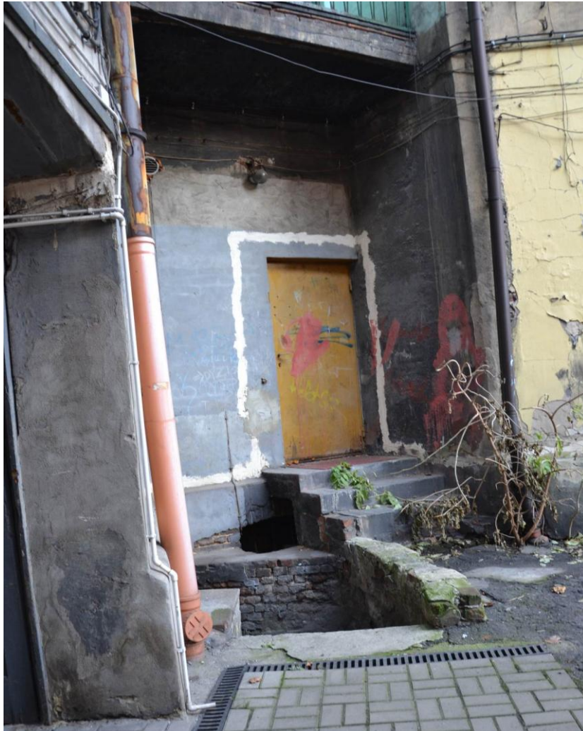
Rys. nr 23. Zawilgocenia ścian przyziemia przejazdu, zmurszałe cegły w murku oporowym – zejście do piwnicy/pom. Technicznego, zniszczone drzwi wejściowe, odparzenia tynku [1.3].
