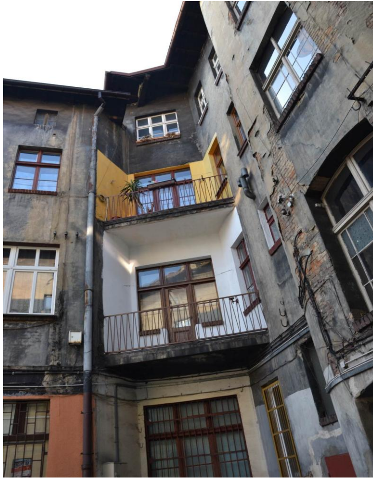
Rys. nr 20. Zacieki, odparzenia tynku, zabrudzenia korozyjne, znacznie wyeksploatowana stolarka okienna poddasza, ogniska korozji belek stalowych balkonów, brak odpowiedniej wysokości balustrady, korozja i wyeksploatowanie rury spustowej [1.3].
