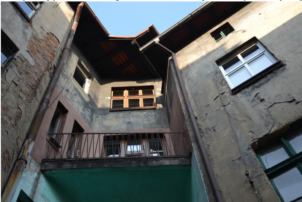
Rys. nr 24. Odparzenia tynku, miejscowe wypłukanie zaprawy cementowej z muru, korozja obróbek i stalowych belek płyty balkonowej, zacieki na elewacji, brak estetyki [1.3].
