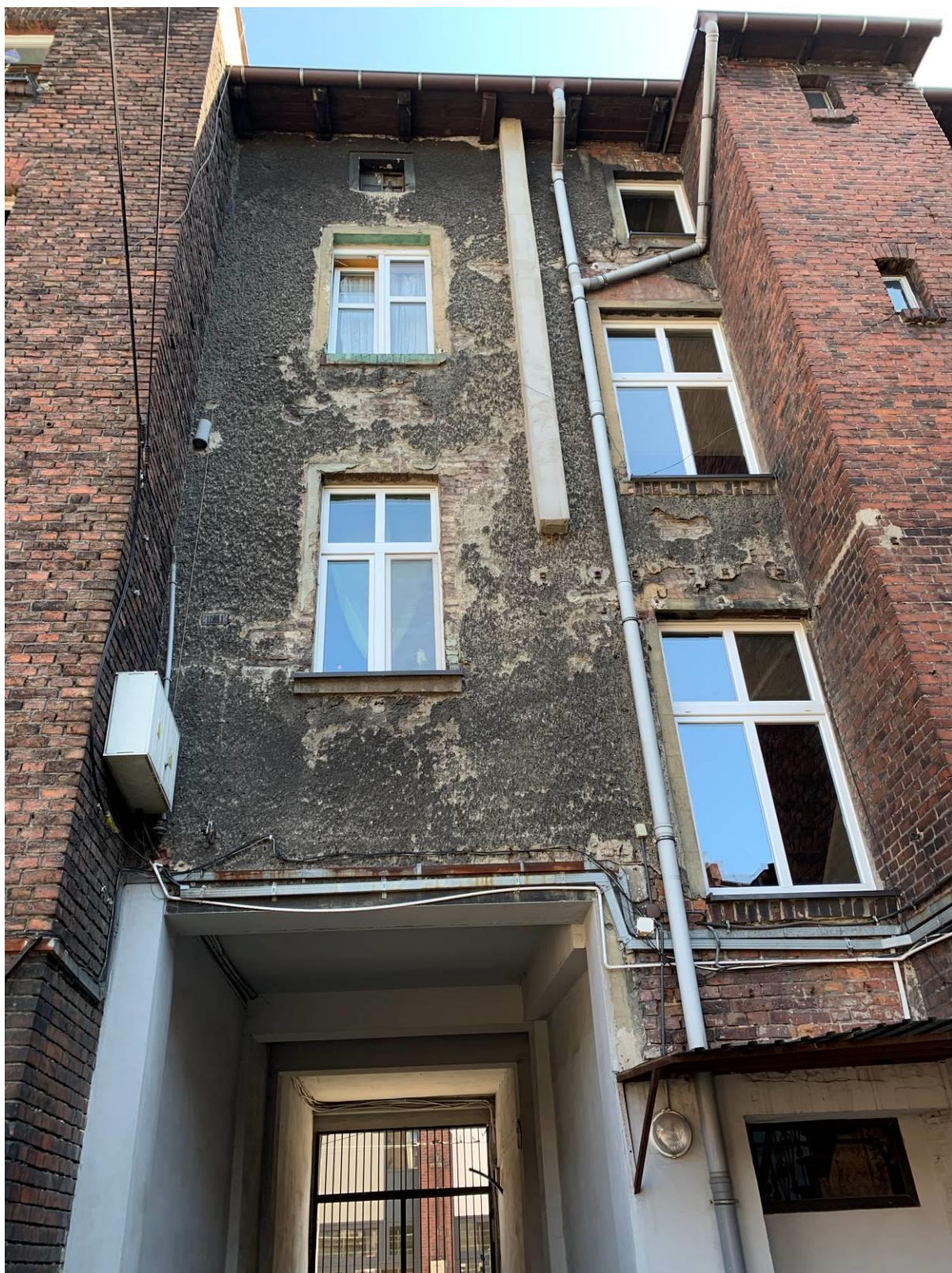
FOT.04. Elewacja zachodnia – budynek fasadowy (obszar tynkowany) – tynki odspajają się i odpadają
