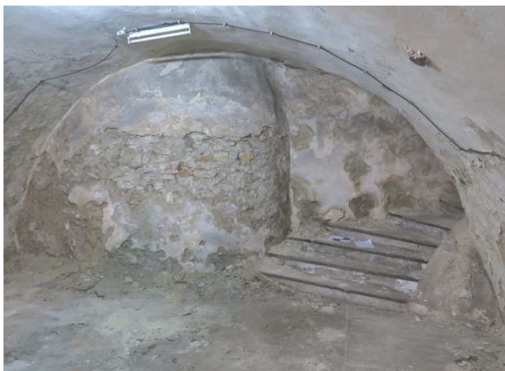
Pom. nr 03 z obniżonym poziomem posadzki i widocznymi uszkodzeniami związanymi z zawilgoceniem
