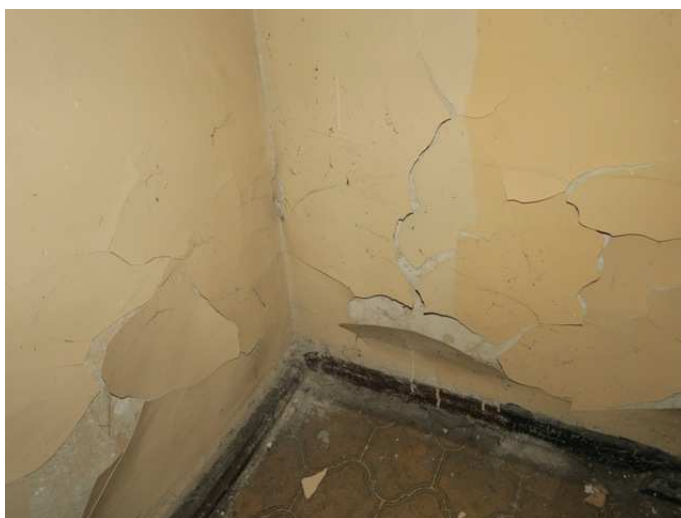
Widok ścian parteru przy posadzce z oznakami niszczenia związanego z zawilgoceniem ścian.
