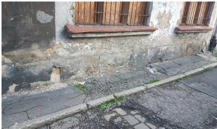
Widok stanu nawierzchni przy budynku i uszkodzenia na cokołowej części elewacji.
