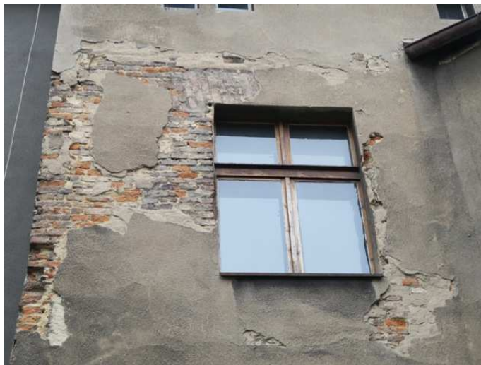
Widok fragmentu elewacji z ubytkami wyprawy tynkarskiej jak również uszkodzeniami i ubytkami substancji muru.
