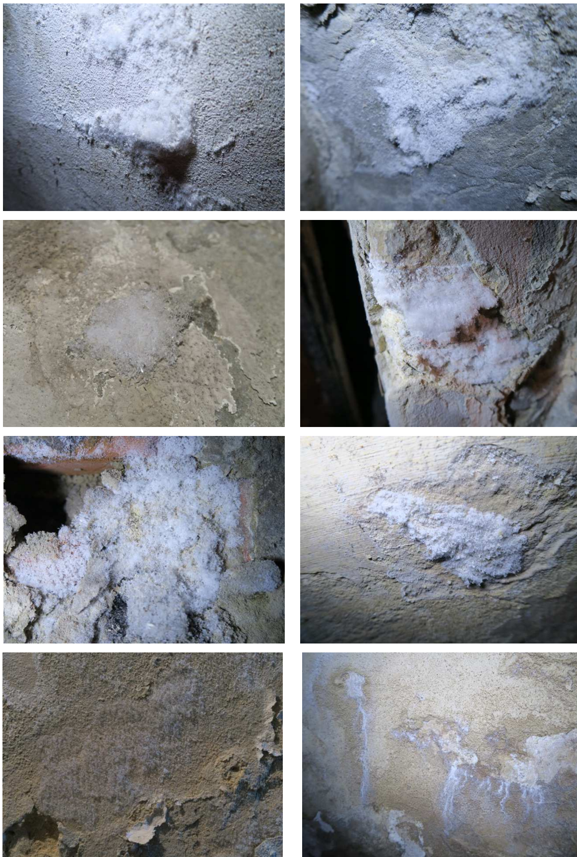
Widok wysoleń i wykwitów solnych na ścianach i sklepieniach w pomieszczeniach piwnicznych
