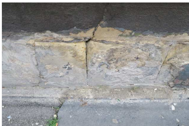
Widok ściany zewnętrznej (cokół) wymurowanej z piaskowca z ubytkami spoin i tynku.
