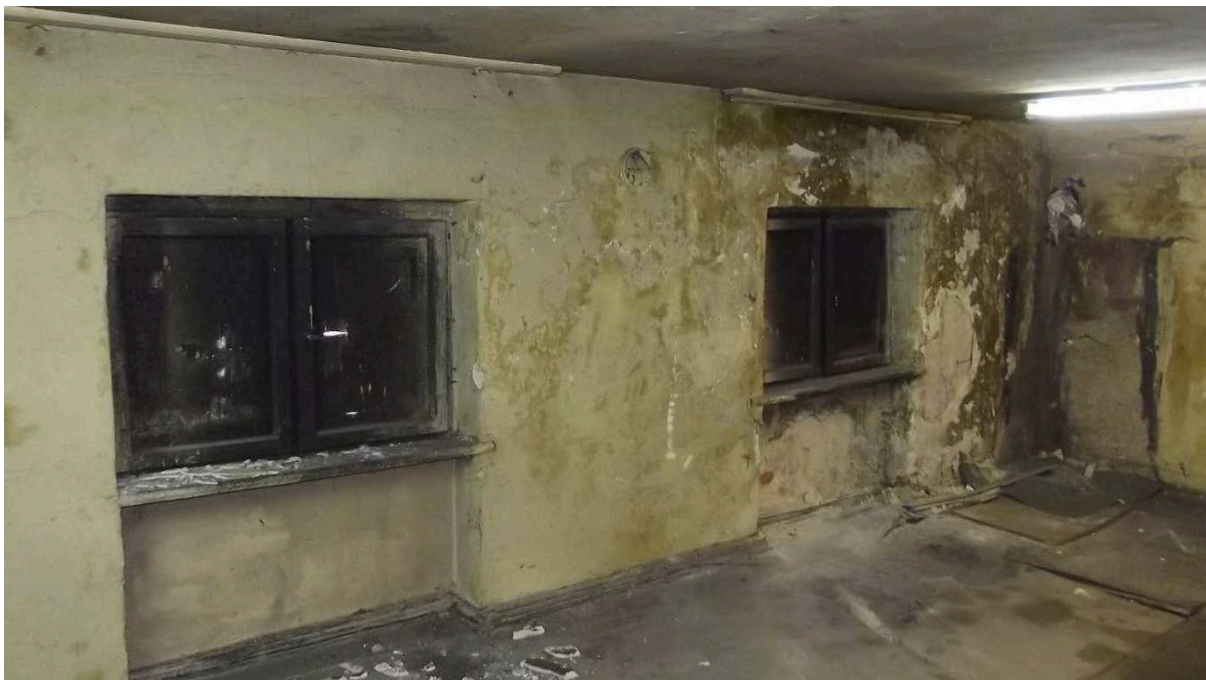
il. 11 - Zacieki dachu i ścian na styku z dobudówką, ekspertyza budowlana
