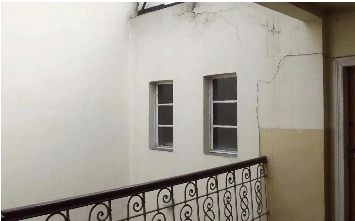
il. 8 - Zacieki w strefie świetlika nad klatką schodową, ekspertyza budowlana
