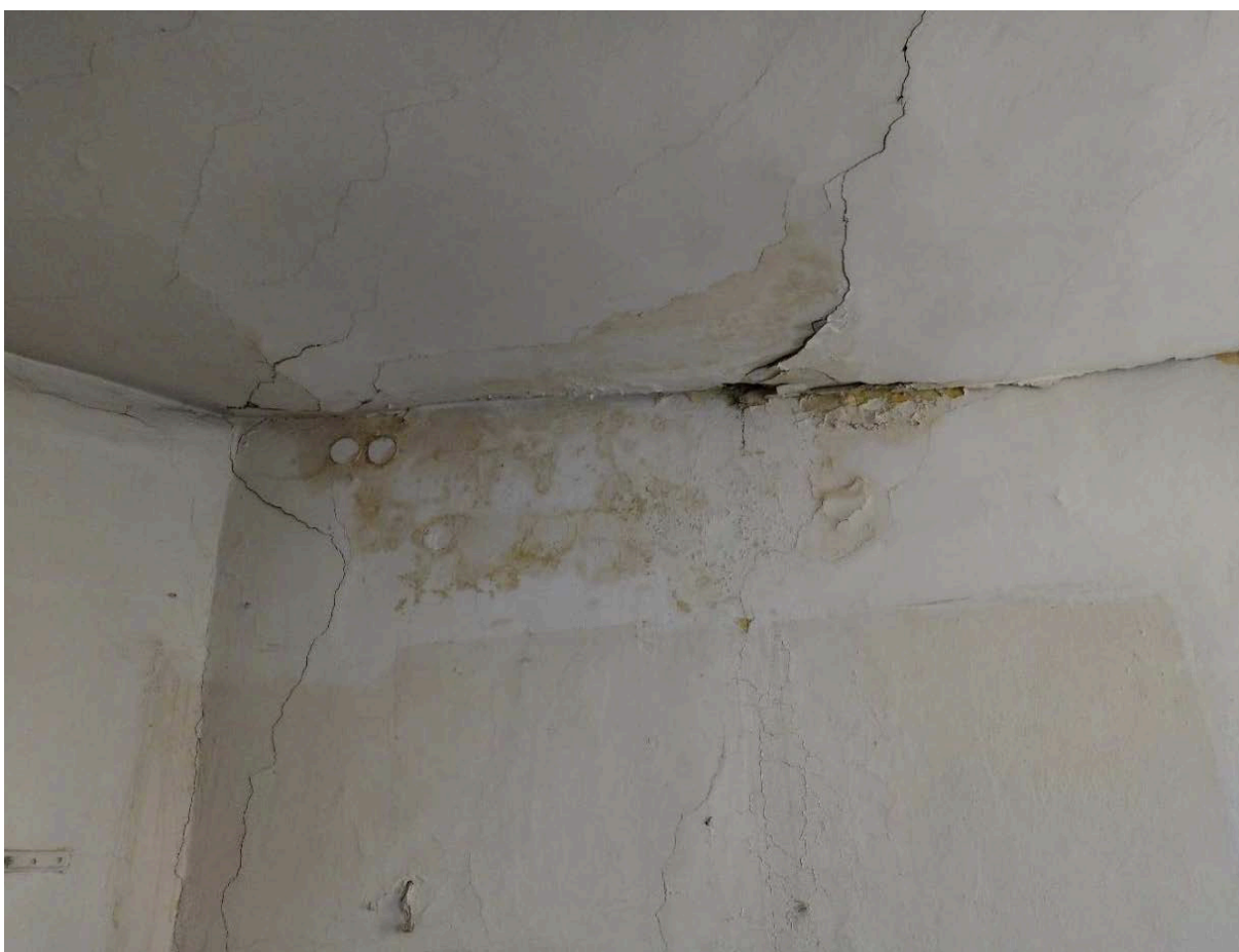
il. 12 - Zacieki i spękania sufitu dachu dobudówki, ekspertyza budowlana
